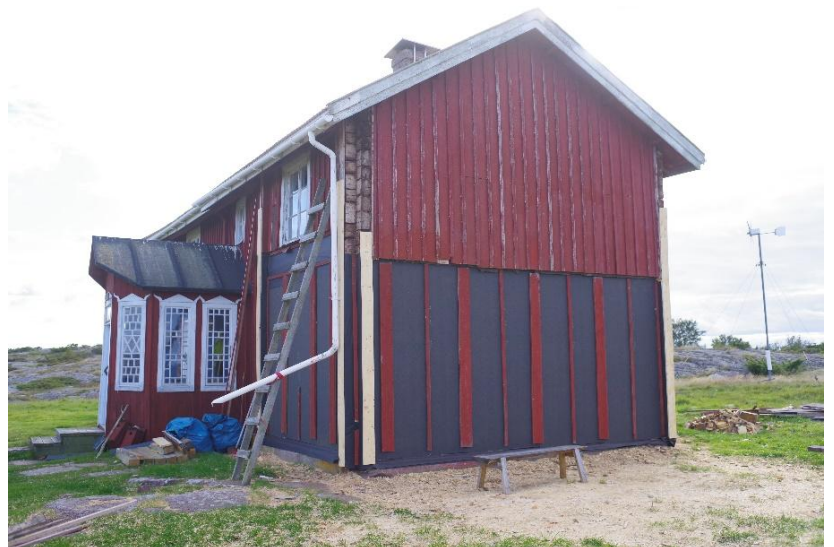
Täckt inför vintern, då stockarna ska få "sätta sej". Brädfodringen återstår, liksom östra fönstret och kammaren invändigt
