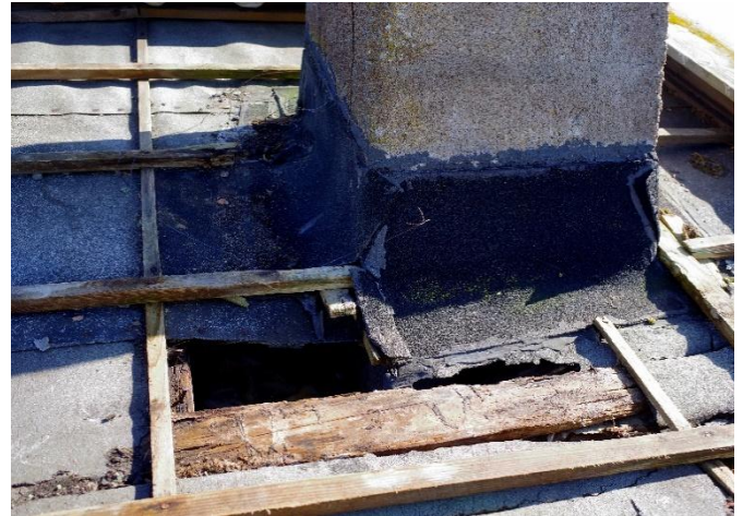
Ovan t.h: Hålet var rätt stort och röta fanns i undertaket.
